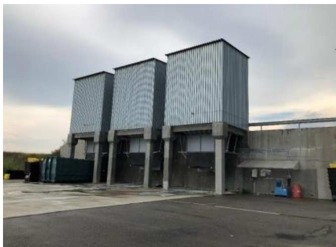
Figura nr. 18 –Stația de transfer Vânu Mare
