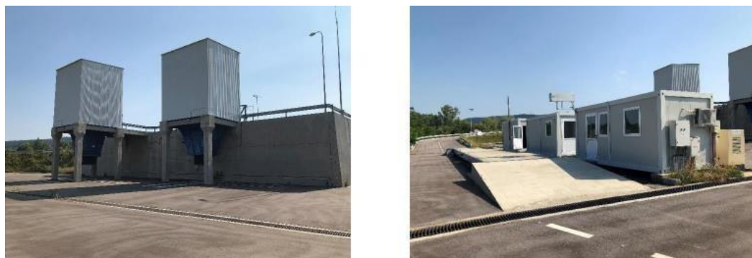
Figura nr. 17 –Stația de transfer Strehaia
